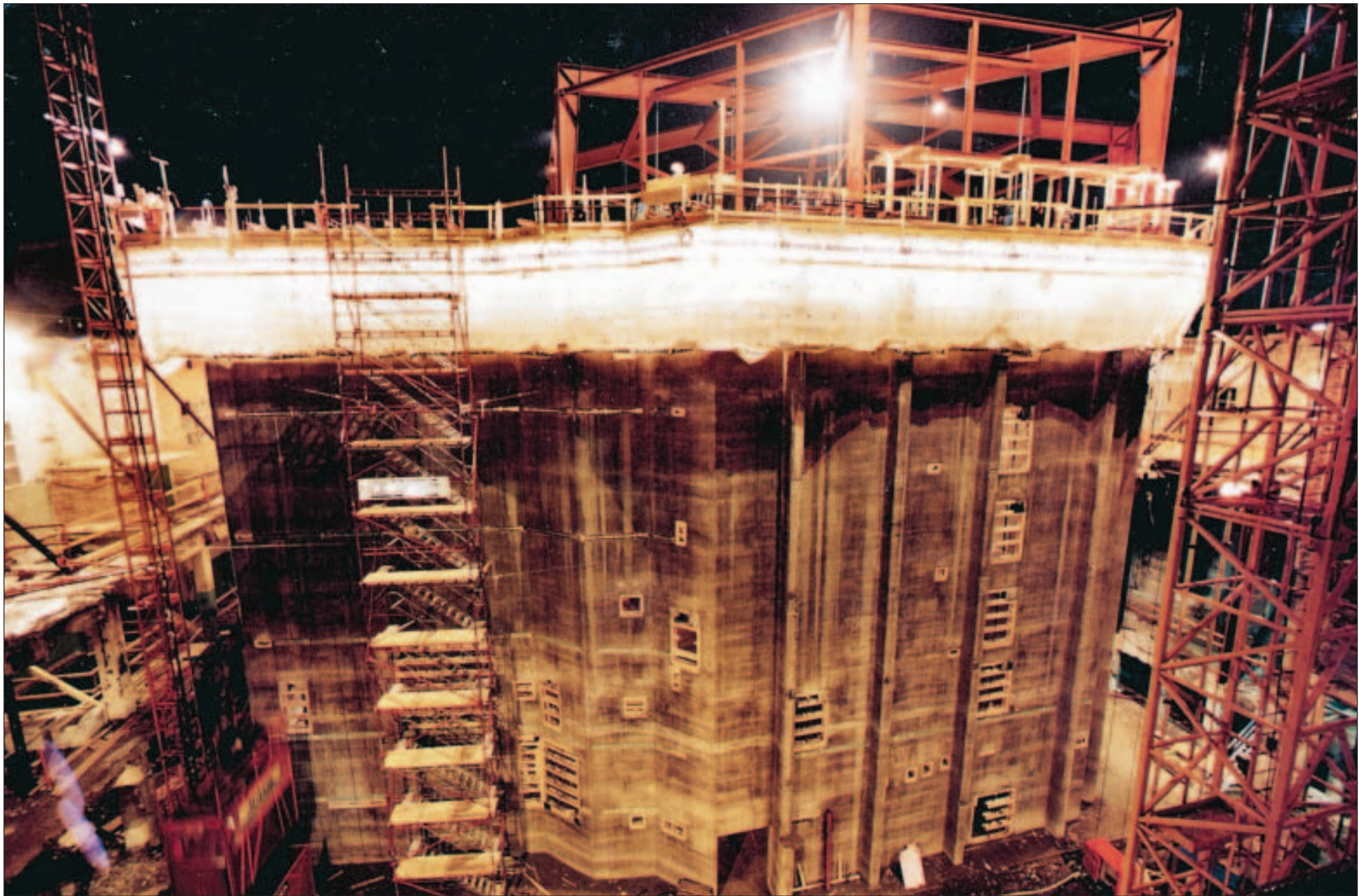
Februari 1993. Gjutningen med hjälp av en glidform vid det som ska bli De Geerhallen är snart avslutad. Byggjobbarna arbetade tio dagar i sträck, natt som dag, med att få väggarna till konsertsalen färdig.
